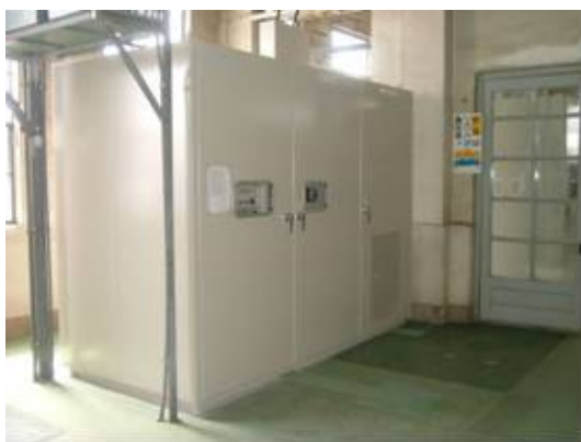
電力変換装置
