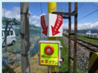
【踏切に設置した非常押しボタン】
